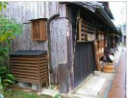
室外機カバーと電力計カバー
