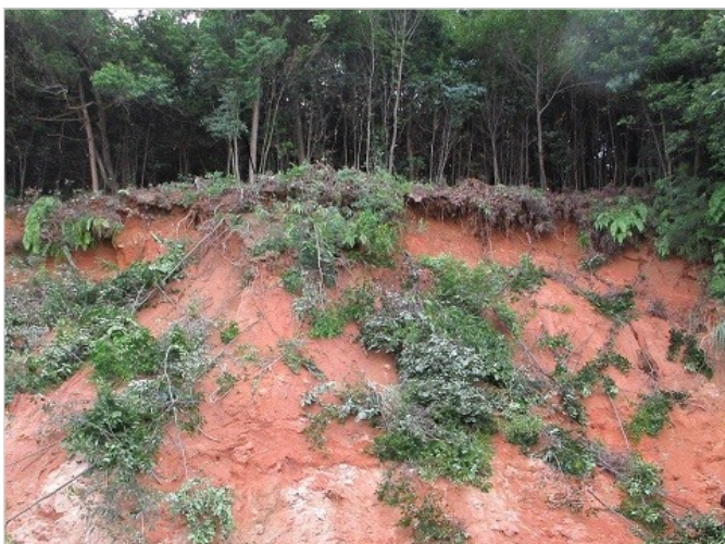
裏山土砂崩れ
